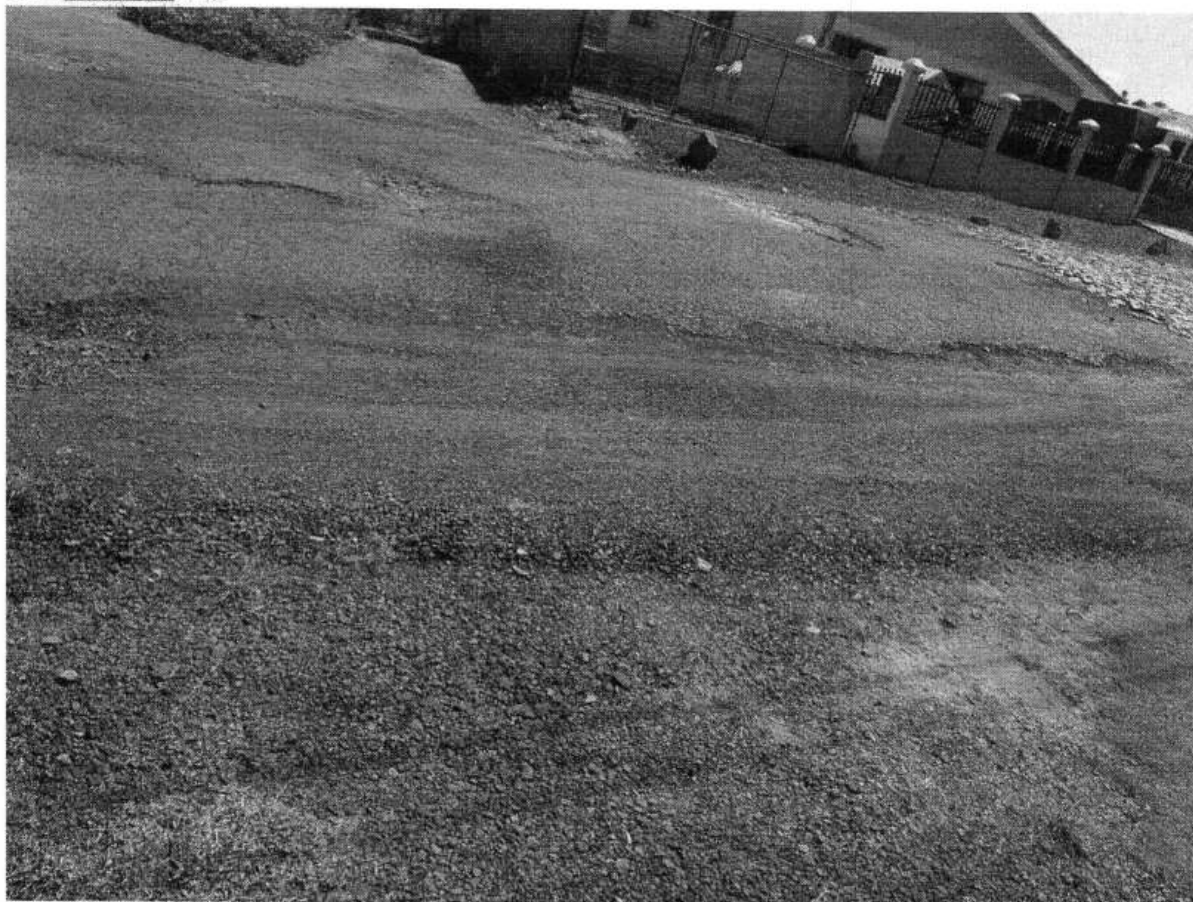
Imagem do desvio dos motorista, para evitar os buracos.
